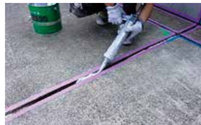
■ 下地補修及び伸縮目地処理 下地補修：ひび割れ補修、剥落・欠損補修等 目地処理：ウレタン系シーリング充填(バックアップ材共)、メジテープ等
