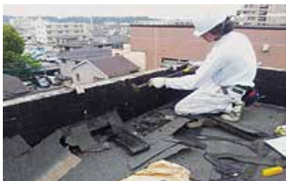
■ 既存立上り・ドレン廻り防水層撤去 (ハツリ機、ケレン棒等を用いる)
